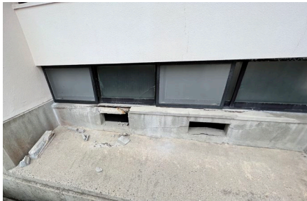
硫黄島体育館：割れた窓かまち
